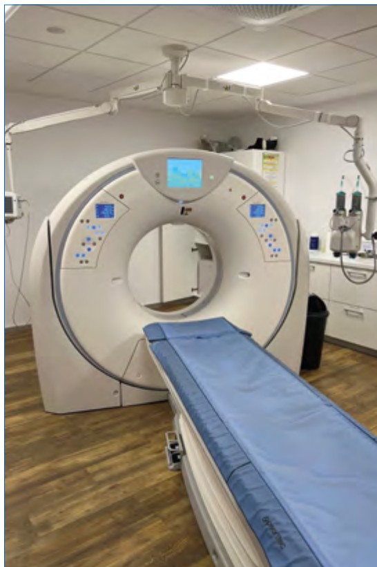
Unter Schlamm: der CT-Raum der Radiologischen Praxis in Euskirchen einen Tag nach der Flutkatastrophe und das neue MRT der Praxis vor einigen Wochen.
