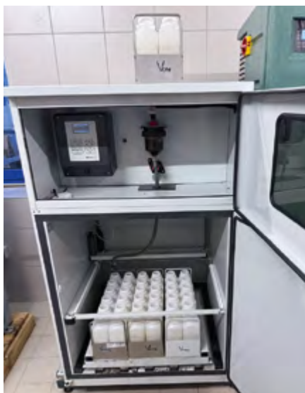
Der automatische Probenentnehmer sammelt über 24 Stunden hinweg Abwasser aus dem Sandfang der Kläranlage. Das gewährleistet eine möglichst repräsentative Probe.
